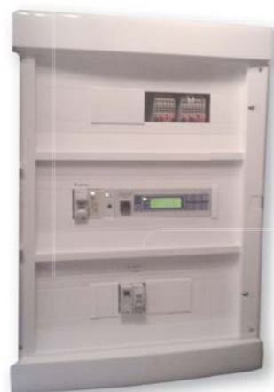
Ukázka instalace regulátoru v rozvaděči.
